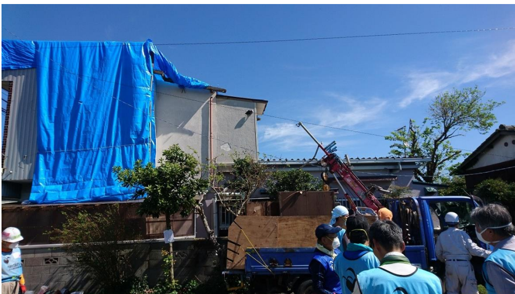
富津市内の被災現場
